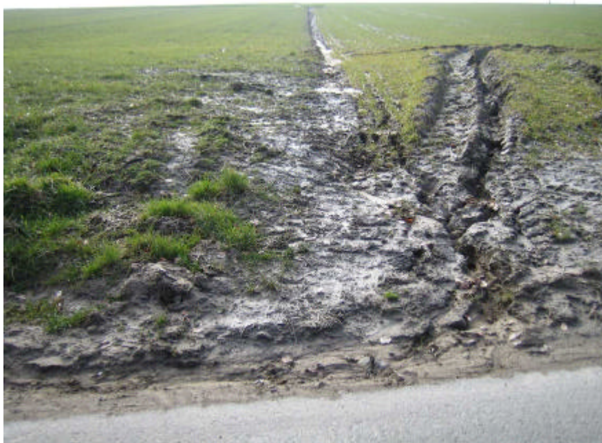
Foto 4.30: Oprit voor de percelen 244308 en 76920 met erosiegeul
