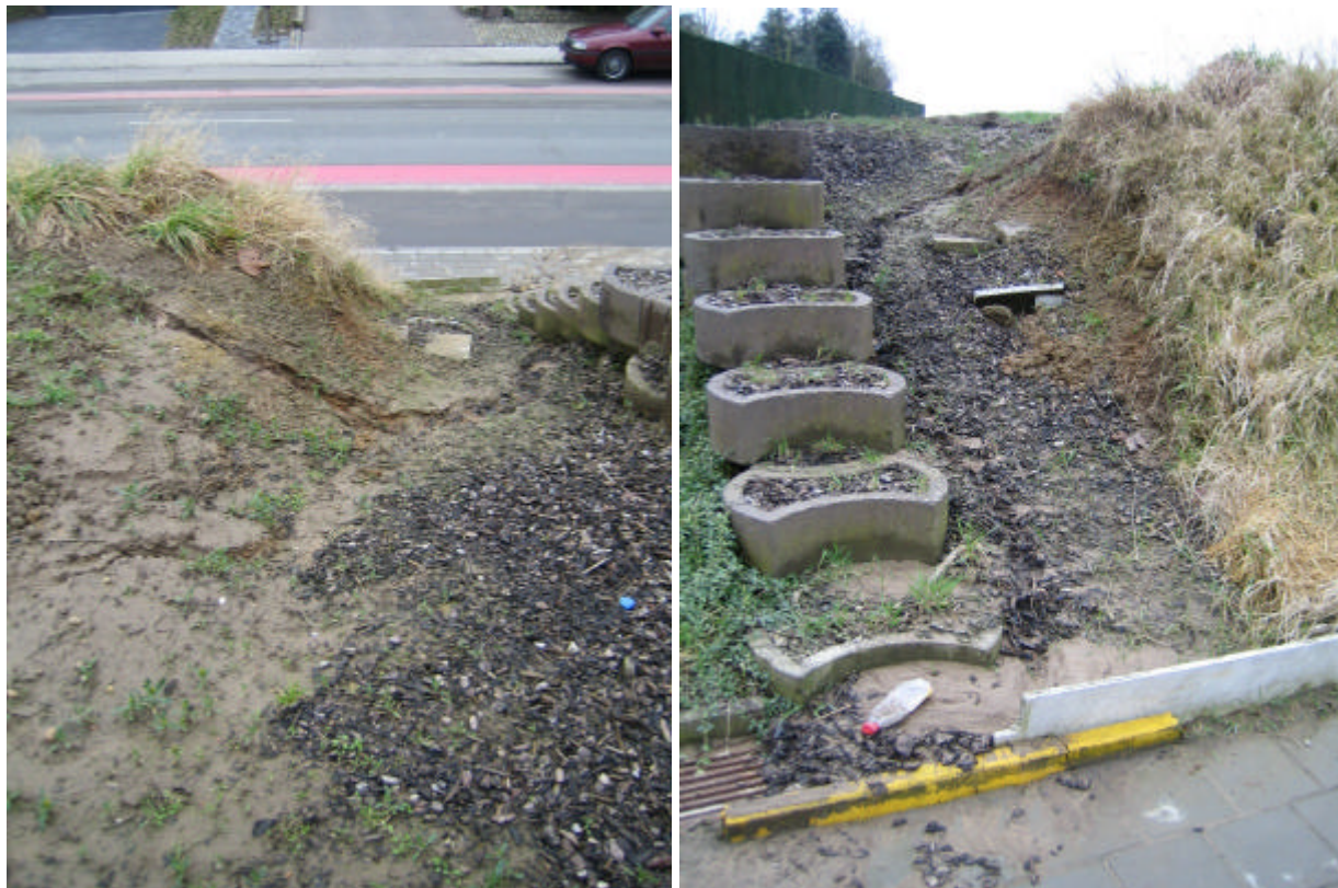
Foto 4.13: Doorbraak van wegberm Statiestraat ter hoogte van perceel 244674
