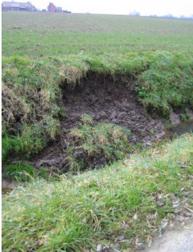
Foto 4.25: Verzakte oever van Nederbeek ter hoogte van perceel 76931
