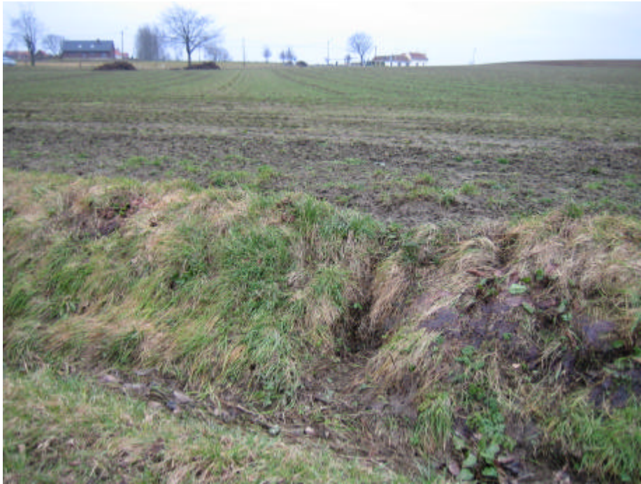
Foto 4.50: Doorbraak oever perceel 70242
