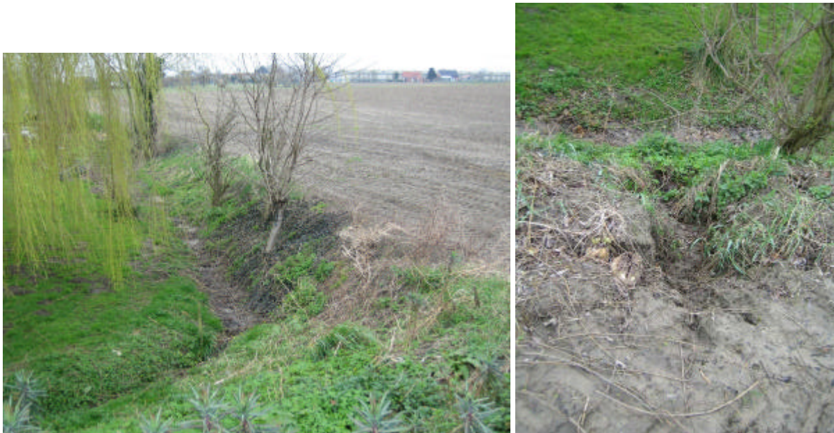
Foto 4.92: Doorbraak van het talud tussen perceel 81079 en de onderliggende tuin
