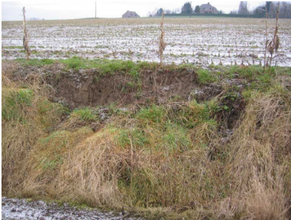
Foto 4.66: Verzakking van de grachtkant ter hoogte van perceel 83332
