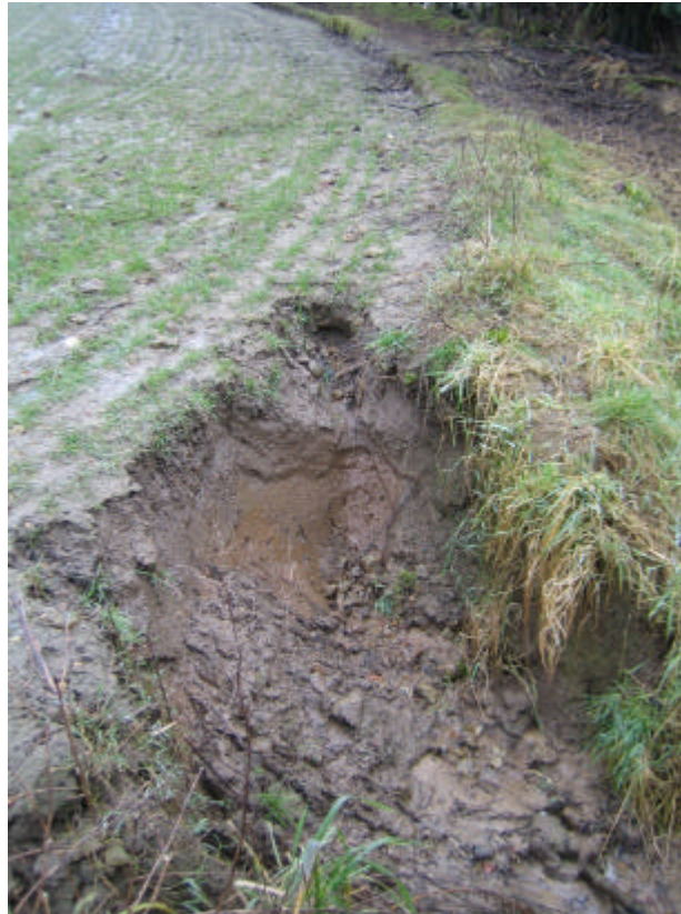
Foto 4.9: Verzakking ter hoogte van perceel 70526
