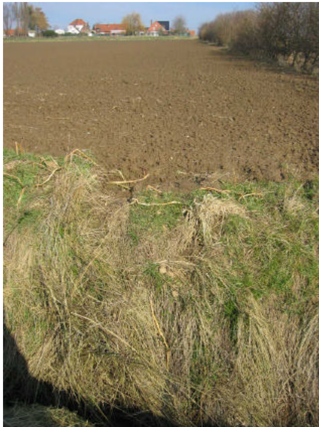
Foto 4.96: Onstabiele grachtkant ter hoogte van perceel 83652a
