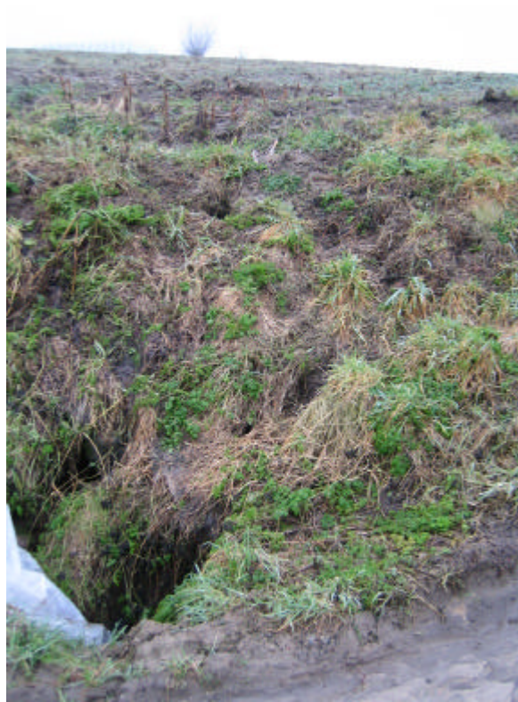
Foto 4.6: Doorbroken oever ter hoogte van perceel 245502
