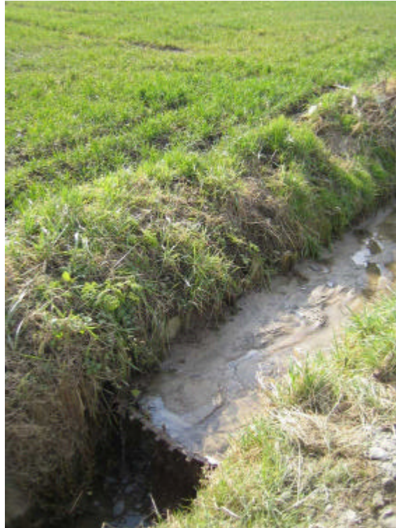
Foto 4.31: Sediment in de gracht aan de Neerbeekstraat ter hoogte van perceel 76839
